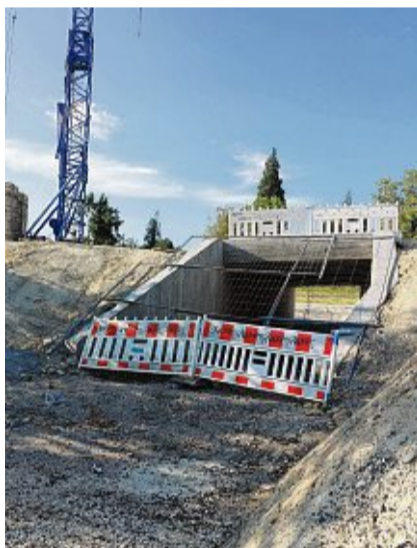
Nichts geht voran an der Unterführung für Fußgänger und Radfahrer bei Hegne.
